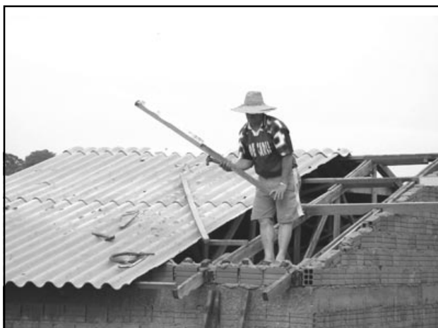
Muitas casas tiveram danos nas coberturas
